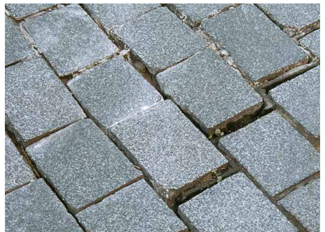
Verschobener Belag als Folge von fehlender Fugenfüllung und entsprechend hohen Verkehrslasten.
