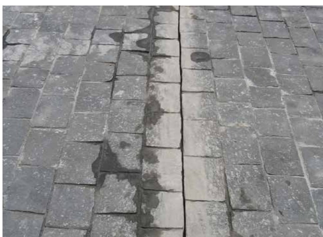
Mittels Flex geöffnete Bewegungsfuge im Straßenbelag.
