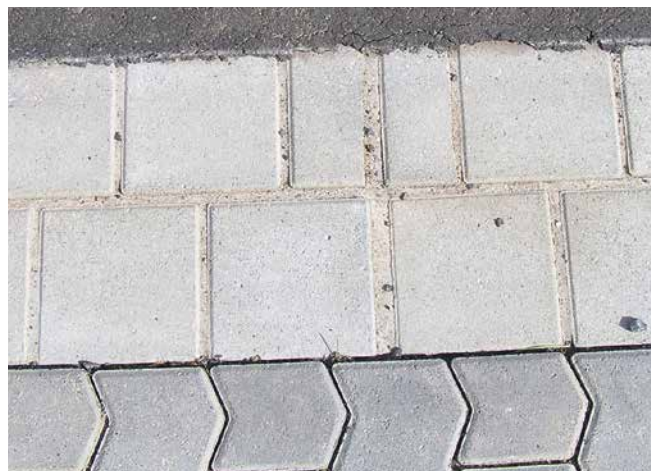
Zugefugte Bewegungsfuge, eine Spannungsableitung ist nicht möglich. Das gesamte Bauwerk kann dadurch Schaden nehmen.
