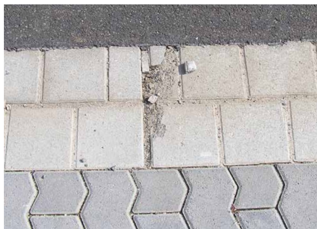
„Ausbrüche an den Pflastersteinen“.
