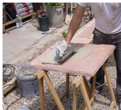
Speziell bei großen Platten ist das Auftragen einer Haftbrücke und das Arbeiten „frisch-in-frisch“ entscheidend für die Langlebigkeit der Konstruktion.
